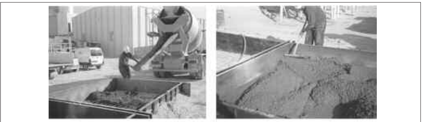
Fig. 9. Elaboración de la losa de hormigón reciclado Fig. 9. Elaboration of the slab made with recycled concrete
